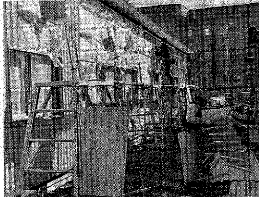
仮設住宅の壁に断熱材を追加する工事が急ピッチで進められている＝宮城県石巻市
